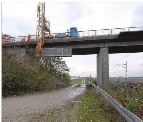
Großer Sanierungsbedarf entsteht immer wieder an den Brückenbauwerken der Gemeinde, wie hier an der Bahnüberführung bei Amselng.
